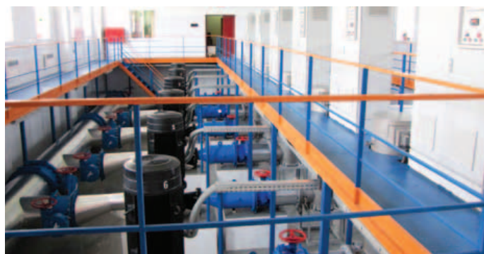
Канализационные станции г. Новосибирск
