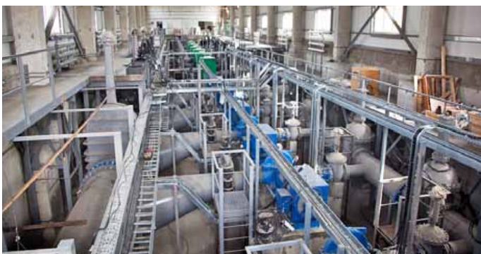
Водоочистные сооружения Краснооктябрьского района г. Волгоград
