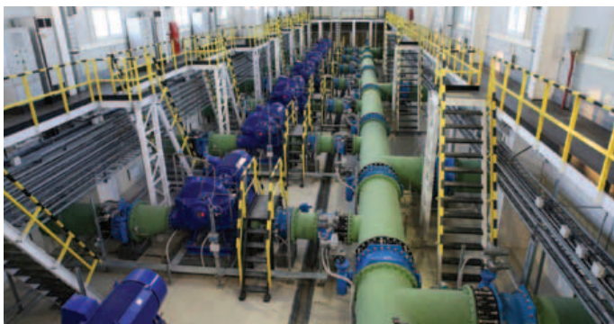
Водозаборный узел «Восточный-2» г. Краснодар
