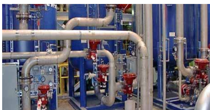
Канализационные станции для санатория «Жемчужина России» г. Волгоград
