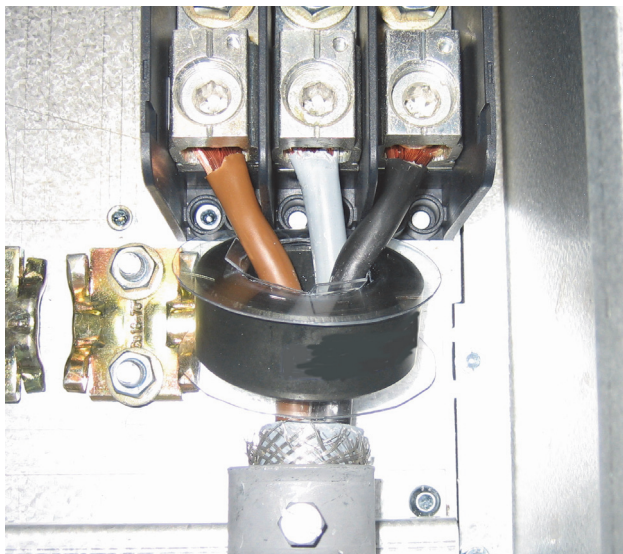
Рис. 49 Ферритовый сердечник установлен на кабелях двигателя
